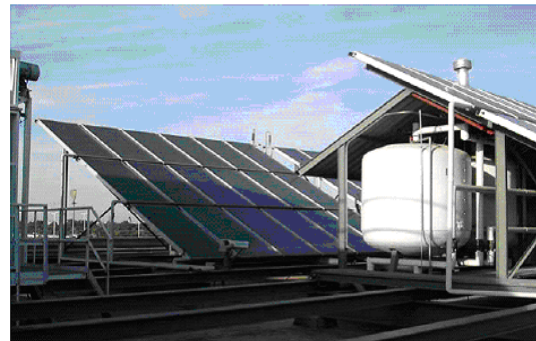
Figura 1: Vista de la planta real
