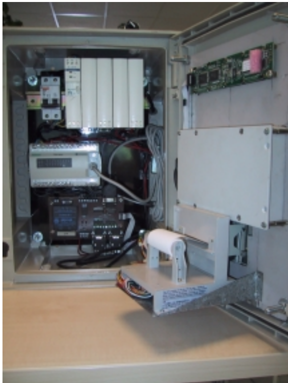
Figura 6: Aspecto interior del RTA
